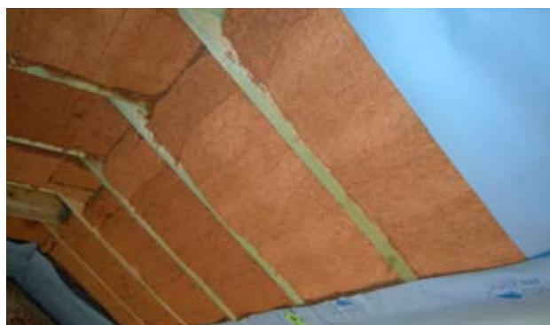
Démolition de l'ancienne toiture, rehaussement des murs de façades et construction et isolation de la nouvelle toiture.
