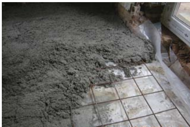
Réalisation de la nouvelle dalle en béton isolant : coulage sur étanchéité et armatures.
