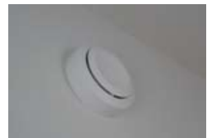
Bouche de pulsion de l'air hygiénique.
