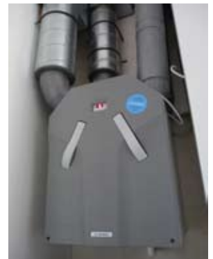
Ventilation double flux avec échangeur de chaleur.
