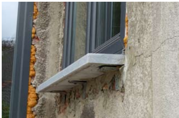
Mousse isolante entre les châssis et les murs et pose des seuils en pierre à ras des fenêtres et du mur.
